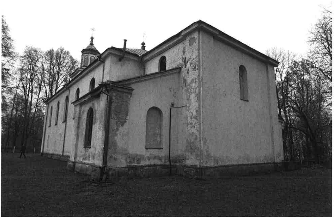
Nr. 3. Bažnyčios pietrytinė pusė. Sienų tinkas baigia nukristi. Pamatai aptrupėję.
