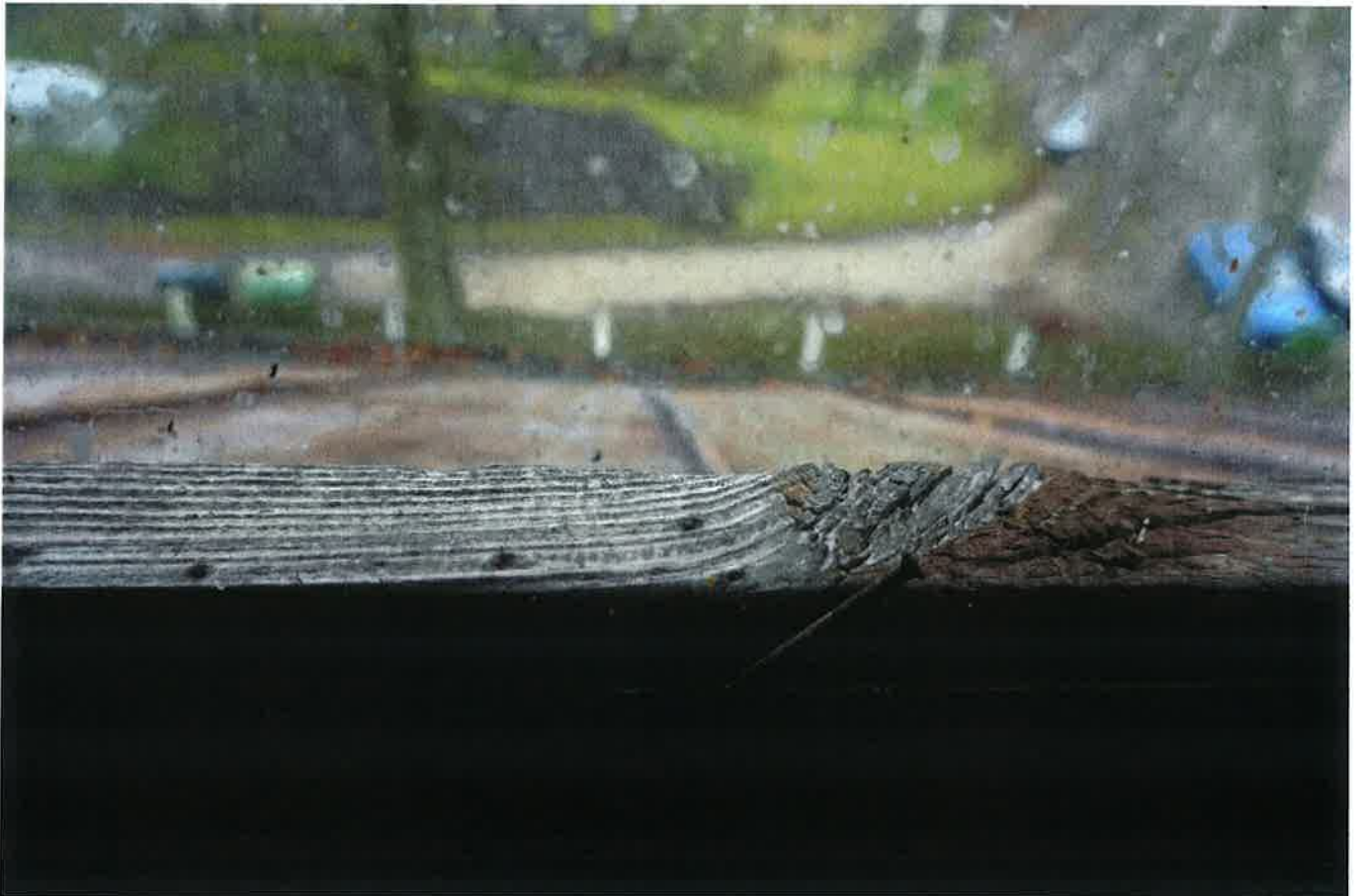
Nr. 10 Bažnyčios pastogė. Pro stoge esančius langelius galima geriau pamatyti lietaus sistemos būklę, stogo dangos nusidėvėjimą. Apžiūros metu nustatyta, kas lietaus sistema užsikimšusi, niekas negali pasakyti kada valyta. Stogo dangos būklė patenkinama.
